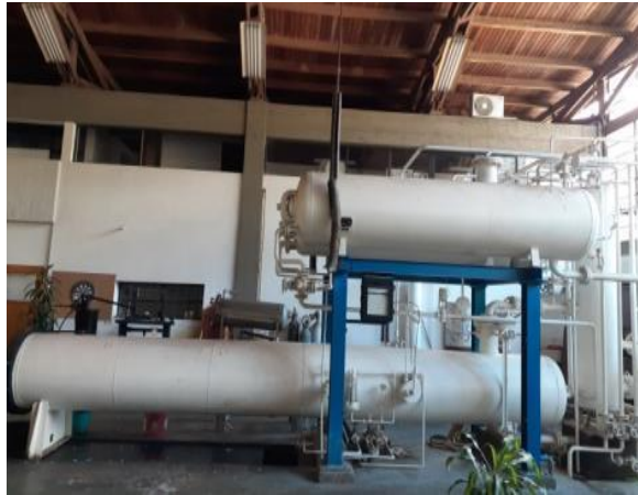
Figura 2. Planta semi industrial de preservación de maderas, LNPF
