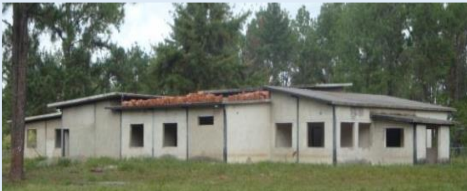
Figura 4.1. Edificación no terminada en el Vivero Las Grullas, Upata. (Foto: Simón Rivas)
